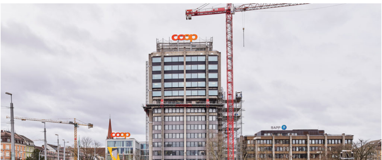
Unten Alt oben Neu: Totalsanierung als «Operation am offenen Herzen» © Burckhardt+Partner AG / Mark Niedermann.
